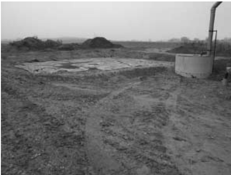
Bild 9. Membranlager för att lagra producerad rötrest. Foto: Åke Nordberg
