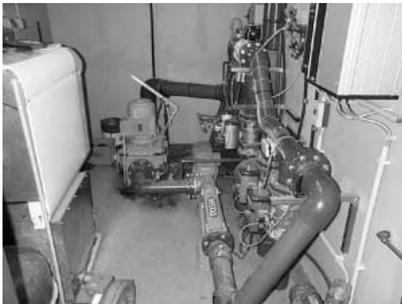
Bild 6. Anläggningen excenterskruvpump och macerator. Foto: Åke Nordberg
