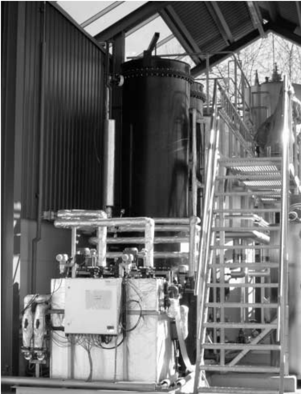
Figur 1. UASB-reaktorerna vid Sjöstadverket.
