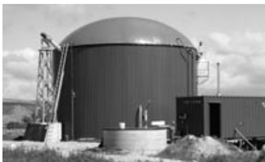
Bild 3. Gas i taket. Röt-kammaren på Hagavik gård har ett dubbelmembrantak där biogas kan lagras. Till höger syns en teknikcontainer som innehåller pump, macerator, gaspanna och styrdator. Framför röt-kammaren ligger den runda blandnings-behållaren. Ställningen på vänstra delen av röt-kammaren fixerar röt-kammarens omrörare.
